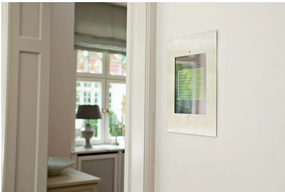
Bild 6: Wandbedienpanel in der Küche für die einfache Bedienung des Smart Homes.
