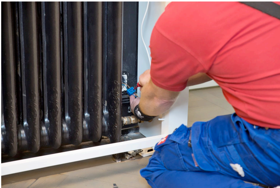
Bild 2: Ausstattung der Heizkörper mit elektrischen Stellventilen und der blauen digitalSTROM-Klemme zur Heizungssteuerung.
